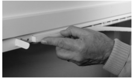
THERMOMAX VENTTIILIN SUODATTIMEN VAIHTO
